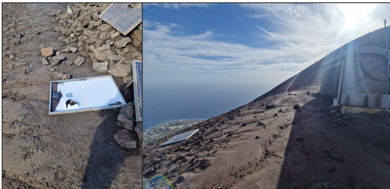
Figura 6 – Danni rilevati alla stazione MIC5 durante il sopralluogo in data 3 Febbraio 2026.
